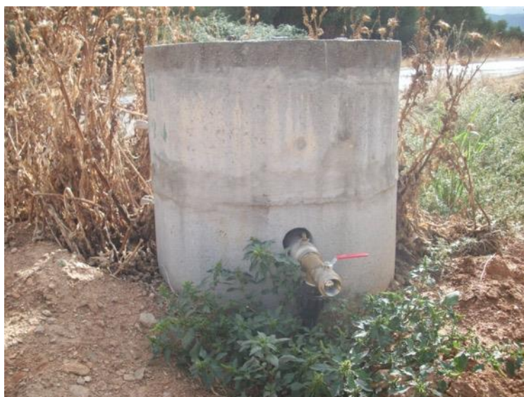
Figura 14 - Caixa de proteção e hidrante (Exemplo)
